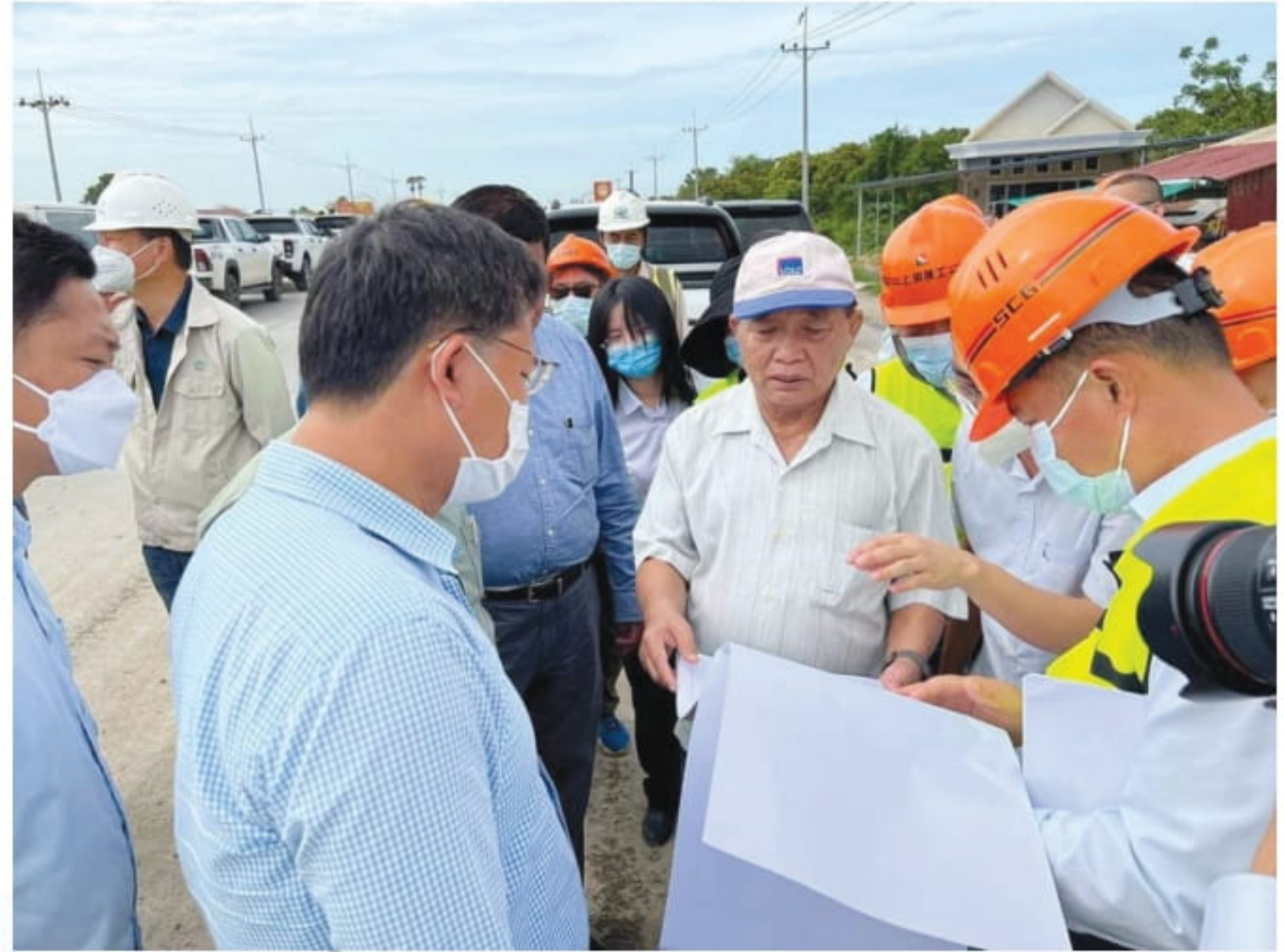
ឯកឧត្តម លីម ស៊ីដេនីន ដឹកនាំក្រុមការងារបច្ចេកទេសត្រួតពិនិត្យ លក្ខណៈបច្ចេកទេសនៃការសាងសង់ផ្លូវក្រវាត់ក្រុងទី៣
