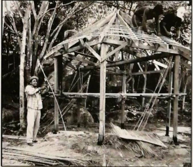
សកម្មភាពជួសជុលផ្លូវ និងរោងសម្រាប់ភ្ញៀវទេសចរក្នុងឧទ្យានសួនសត្វ និងមជ្ឈមណ្ឌលសង្គ្រោះសត្វព្រៃភ្នំតាម៉ៅ
