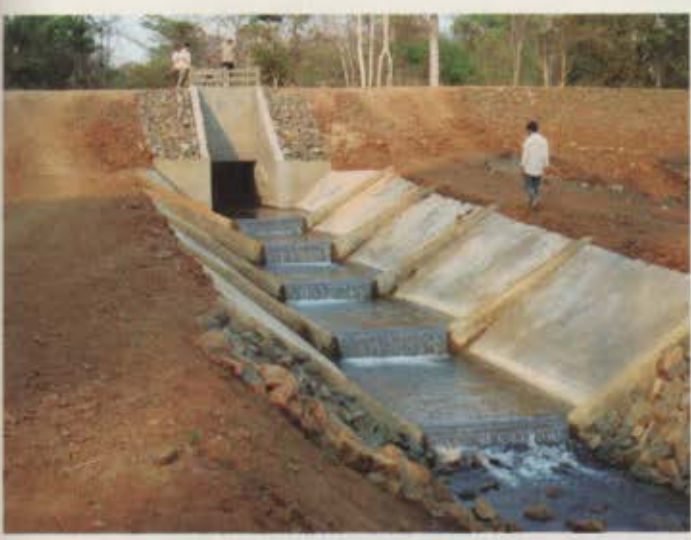
សំណង់បញ្ជូនទឹកក្បាលប្រឡាយរងក្រោយពេលសាងសង់រួច Main canal intake structure after construction
