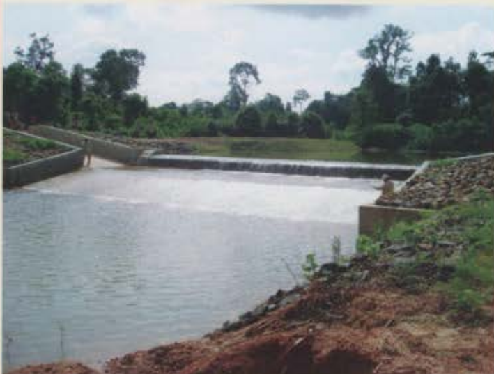
ទិដ្ឋភាពសំណង់បង្ហូរទំនប់ អូរ ពាង ក្រោយពេលសាងសង់រួច View spillway structure of O Tang Irrigation Dam after construction
