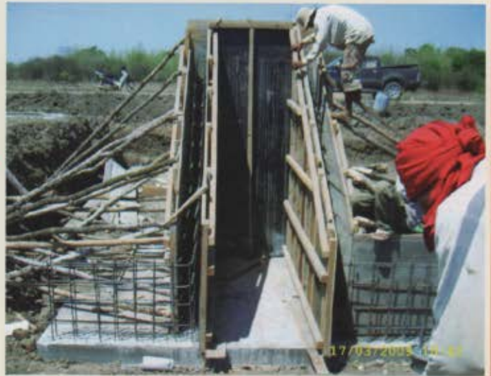
↪ សកម្មភាពសាងសង់សំណង់បញ្ជូនទឹកក្បាលប្រឡាយមេ Activities construction inlet structures at the head of the main canal
