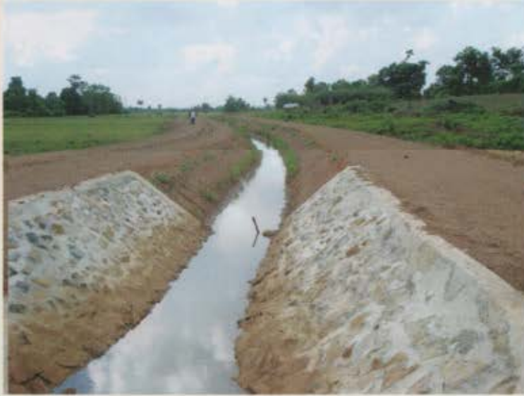
↪ ទិដ្ឋភាពប្រឡាយមេក្រោយពេលស្តាររួច View main canal after rehabilitation
