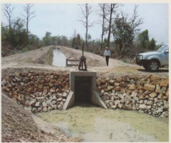
សំណង់បញ្ជូនទឹកក្បាលប្រឡាយរងក្រោយពេលសាងសង់រួច Secondary canal structure after construction
