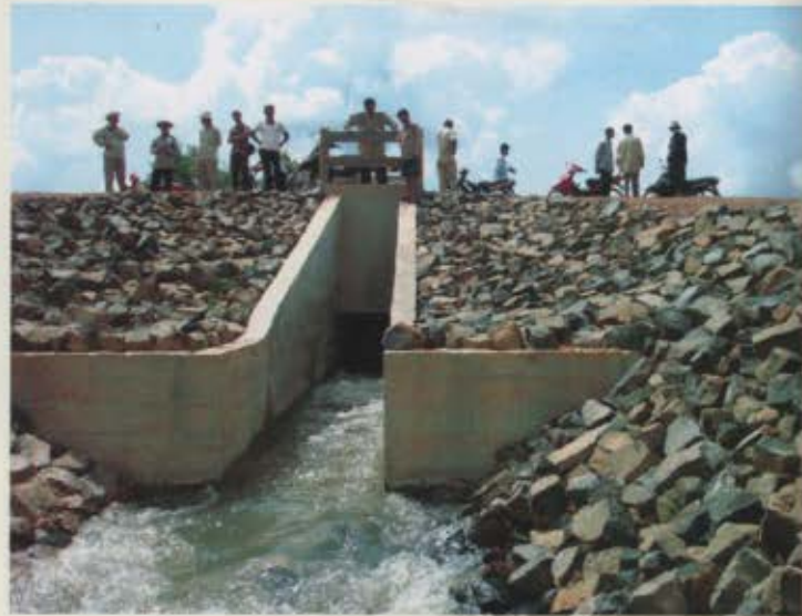
សំណង់ដោះទឹកទំនប់ អូរ ពាង ក្រោយពេលសាងសង់រួច Drainage structure of O Tang Dam after construction
